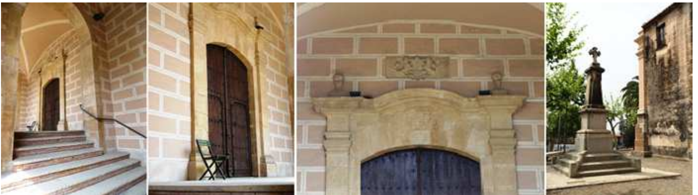
❶ Con dos escaleras laterales se ingresa por la puerta principal situada a los pies del templo. ❷ Puerta de Arco rebajado con columnas rectas adosadas. ❸ Sobre el arco de la puerta un escudo heráldico con dos leones rampantes, con la fecha de 1783 y sobre la clave de la puerta han eliminado los que un relieve sobre un círculo. ❹ Cruz a la que le han quitado la lápida existente.
