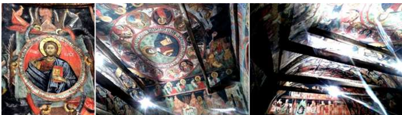
❶ Escena central de la bóveda con Nuestro Señor Jesucristo. ❷ Otra con una orla circular que contiene a 12 santos al rededor. ❸ Parte inferior de la nao con los tirantes de la bóveda que también esta policromados.
