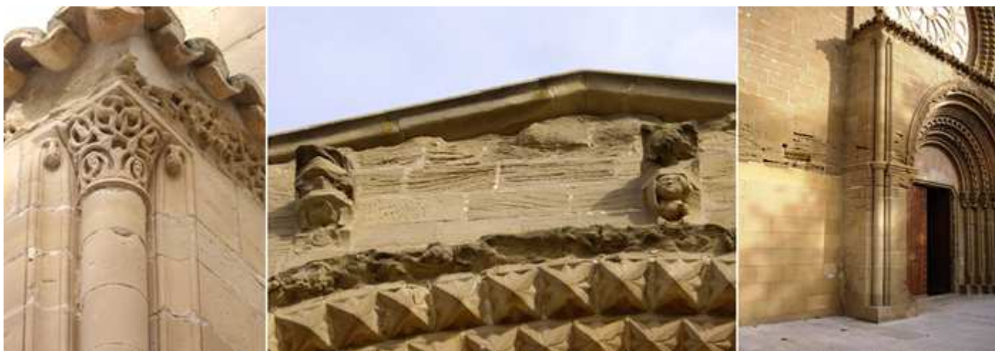
❶ Y columna adosada, sobre el cuerpo saliente de la portada, que la protege con un tejazoz ❷ Los dos canecillos que conserva bajos su alero moderno. ❸ El tímpano es liso, presumiblemente estaría decorado/pintado .
