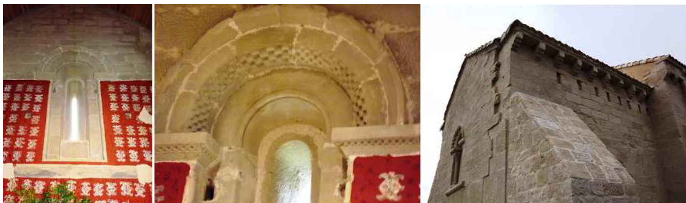
1 En la cabecera aparecieron después de la restauración restos de pintura mural. 2 En el interior de su ventana con un arco ligeramente de herradura. Este vano por su interior es anterior a la época románica. 3 Muro note con canchillos de rollo.
