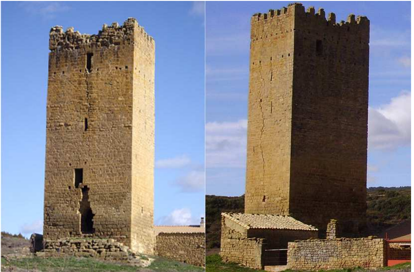
❶ Fachada principal del Castillo de Obano Y con su acceso en parte desprendido. ❷ Parte posterior junto a las construcciones agrícolas.
