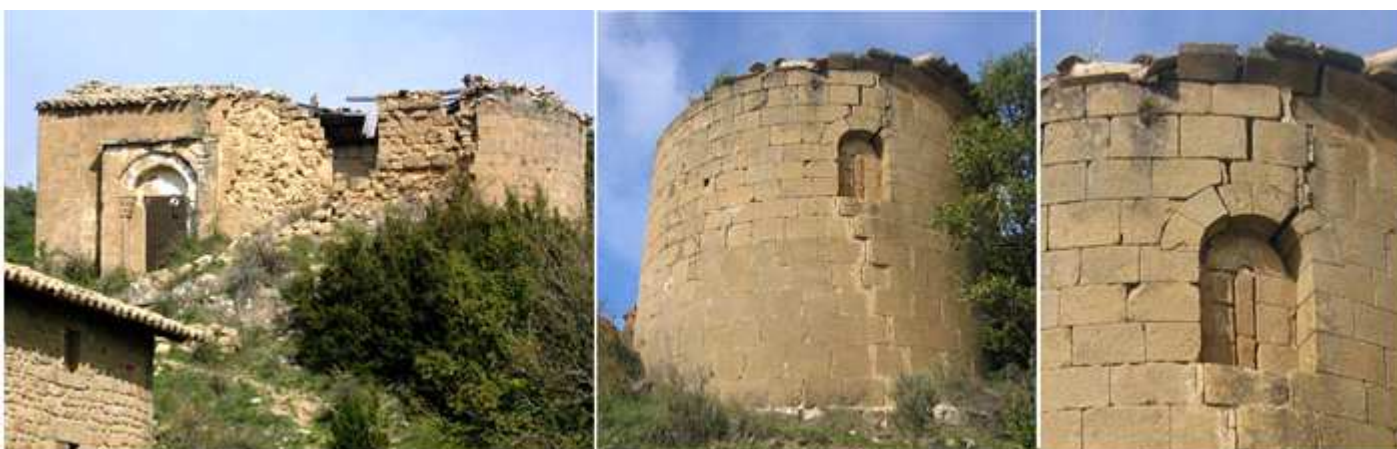
❶ Parte de su fachada meridional se ha hundido lo mismo que su cubierta. ❷ Ábside que posee una ventana y parte de su alero. ❸ Ventana de medio punto con otra dentro y que esta cegada.
