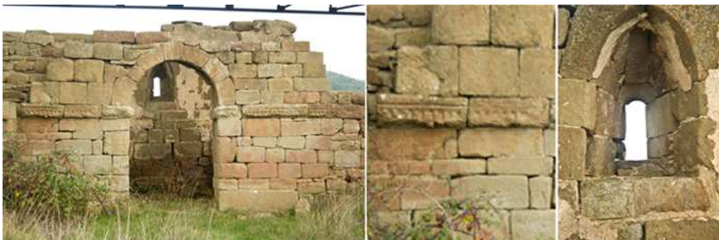
❶ Parte de las paredes de la iglesia donde se encuentra su portada es lo que se mantiene en pie protegido por una cubierta. Suportada es de medio punto y sus dovelas lisas descansan sobre una imposta corrida que se mantiene por el muro. ❷ Detalle de un par de tramos de la imposta. ❸ Ventana desde el interior con gran derrame que se convierte en un arco apuntado. Fotos cedidas por gentileza de http://www.miniquias.com/
