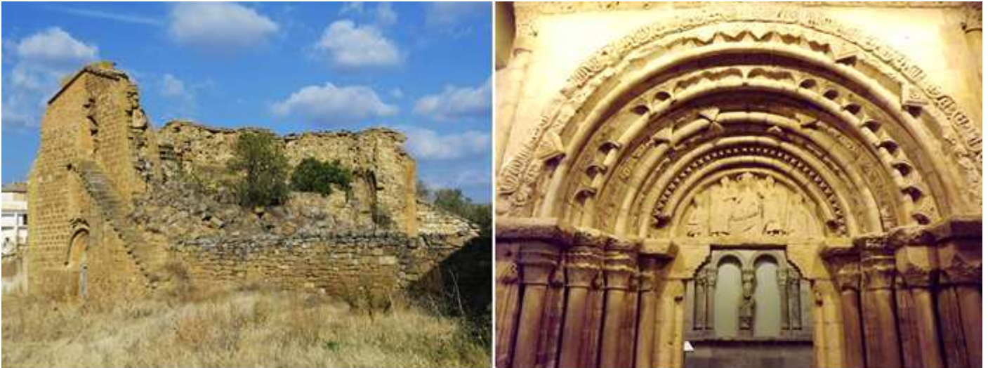
1 Estado del lateral epistolar y que ante la falta de su puerta se ha colapsado. 2 La
