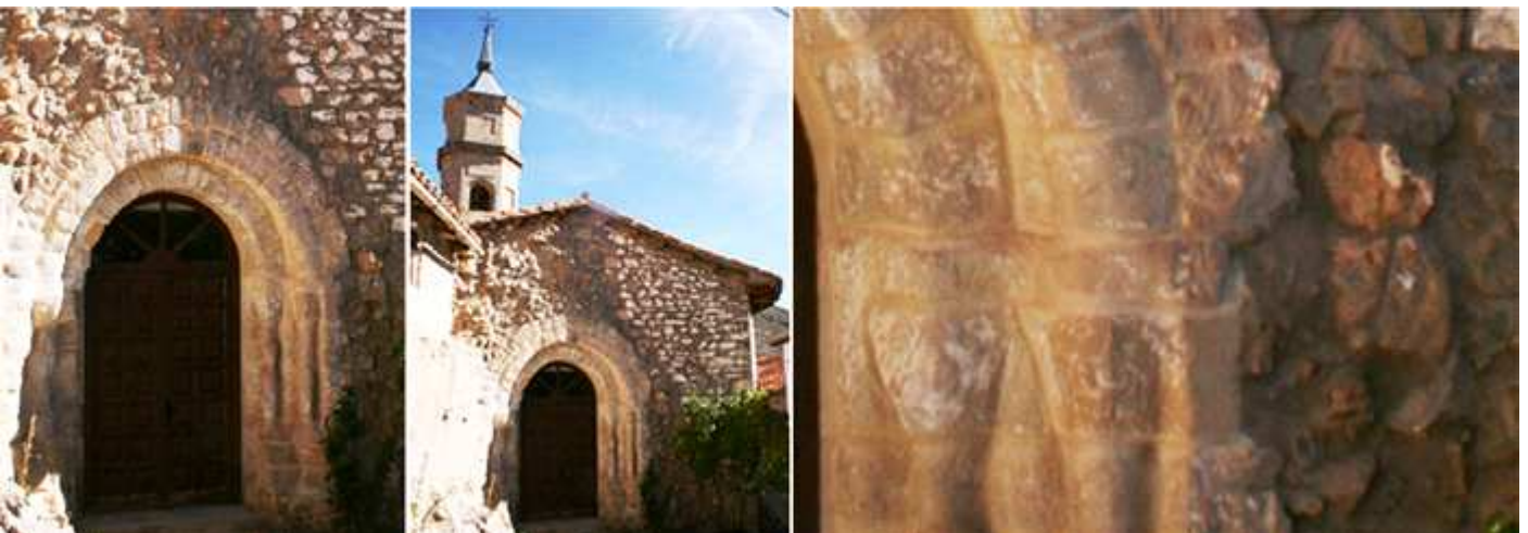
❶ Imagen de la portada con los restos de la misma. ❷ Fachada de las escuelas donde se encuentra la portada. ❸ Detalle de los capiteles y columnas del lado derecho, las menos erosionadas.
