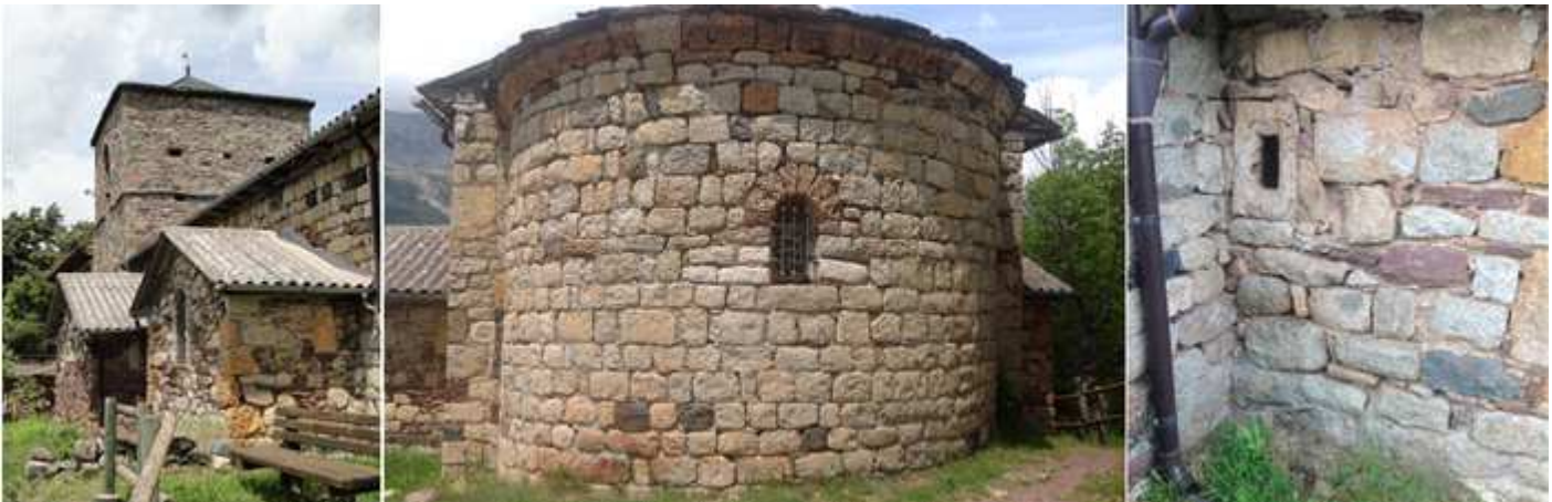
❶ Las dos construcciones adosadas con cubiertas a dos aguas con uralita. ❷ Su ábside semicircular con la abertura de una ventana, su cubierta es con lajas de piedra. ❸ Pequeña ventana de la capilla que hay en lado epistolar.
