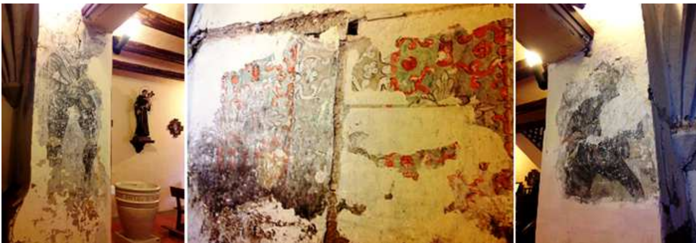
❶ Pinturas en el marco de su puerta a la parte izquierda. ❷ Retos sobre uno de los muros. ❸ Y las pinturas sobre la jamba de la derecha.
