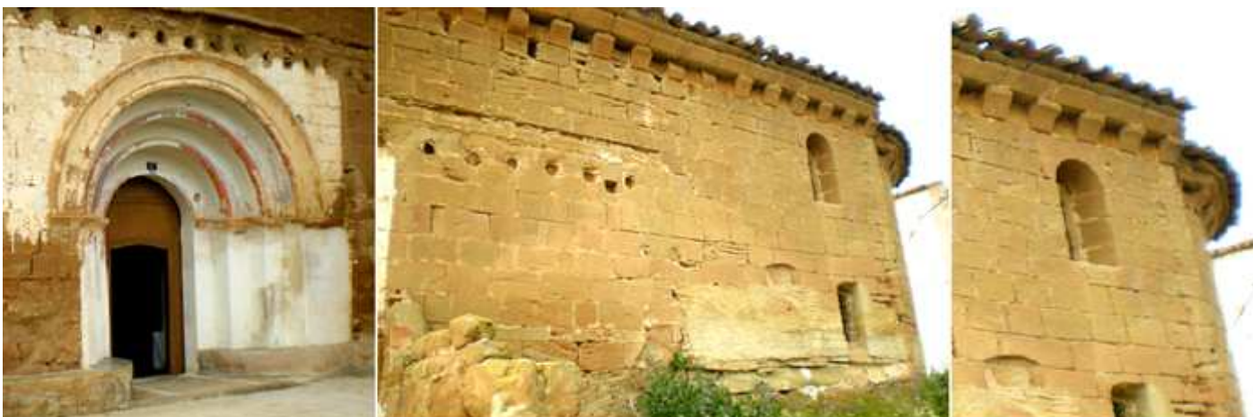
❶ Su puerta con arco de medio punto con tres arquivoltas vaquetonas y provista de guarda lluvias, que descansan en una imposta corrida. ❷ A la derecha el tramo del presbiterio abierto con dos ventanas. ❸ Detalle del alero y sus canecillos. Fotos: www.fraella.com
