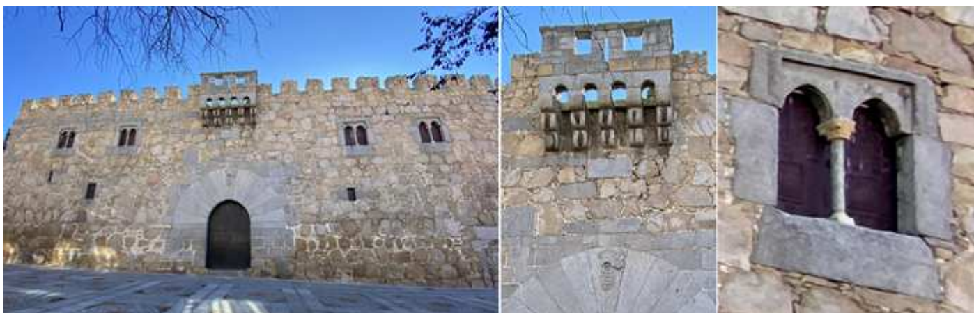
❶ Construido en el S. XIII con piedra granítica de esta fachada occidental. Las partes más antiguas datan de este siglo. ❷ Sobre su puerta este matacán. ❸ Sus ventanas son góticas.
