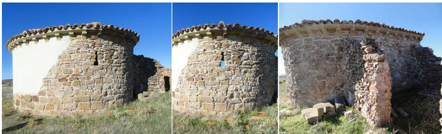
❶ Su ábside semicircular restaurado en el 2015. ❷ Es una construcción con sillarejo irregular en su alero de sus catorce canchillos se conservan cuatro originales, y esta cabecera tiene una pequeña abertura como ventana. ❸ Ruinas del espacio que tenía adosado.
