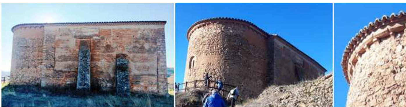
❶ Exterior del lado norte donde cuenta con dos gruesos contrafuertes. ❷ En su ábside cuenta con una ventana como la del presbiterio y algo ladeada para captar más tiempo del sol. ❸ Su alero cuenta con unos canecillos lisos cóncavos. Fotos Ángel Lasa.
