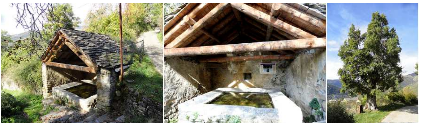
❶ El lavadero, llamado en aragonés "bazi6n o ciumo". ❷ Está situado en el barranco que unía las dos partes del pueblo: Barrionuevo y Puyal. ❸ Y llegando a la iglesia está la casa de la abadía, que parte de la misma está hundida y sin salvaci6n para el resto, aboca a terminar hundiéndose.
