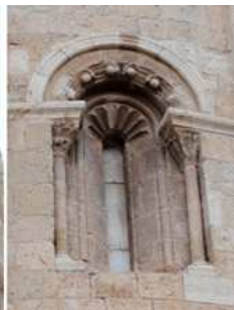
❼ Y su ventana que en su interior se encuentra cegada por el revoque necesario para las pinturas murales.
