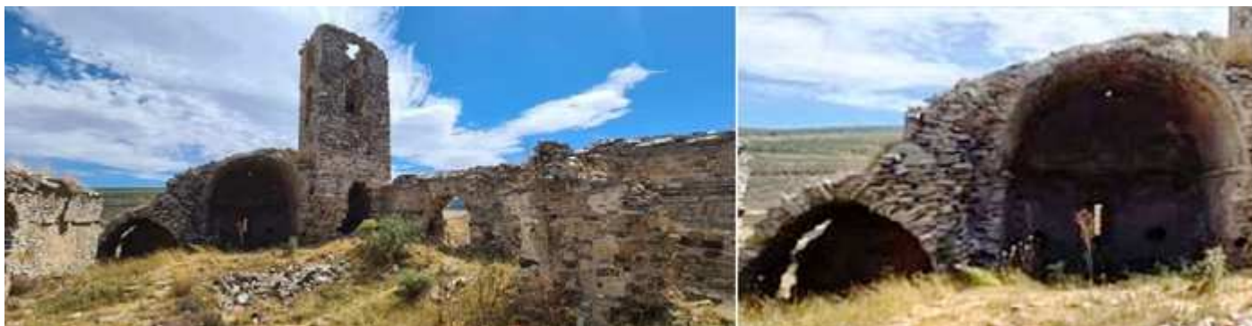
❶ Parte interior de estas ruinas, presenta tres naves románicas que solo se mantienen las partes de sus paredes, la torre y su cabecera con el presbiterio y su ábside semicircular abierto con una ventana. ❷ Detalle de su cabecera con bóveda de cañón y de horno, con una imposta corrida.
