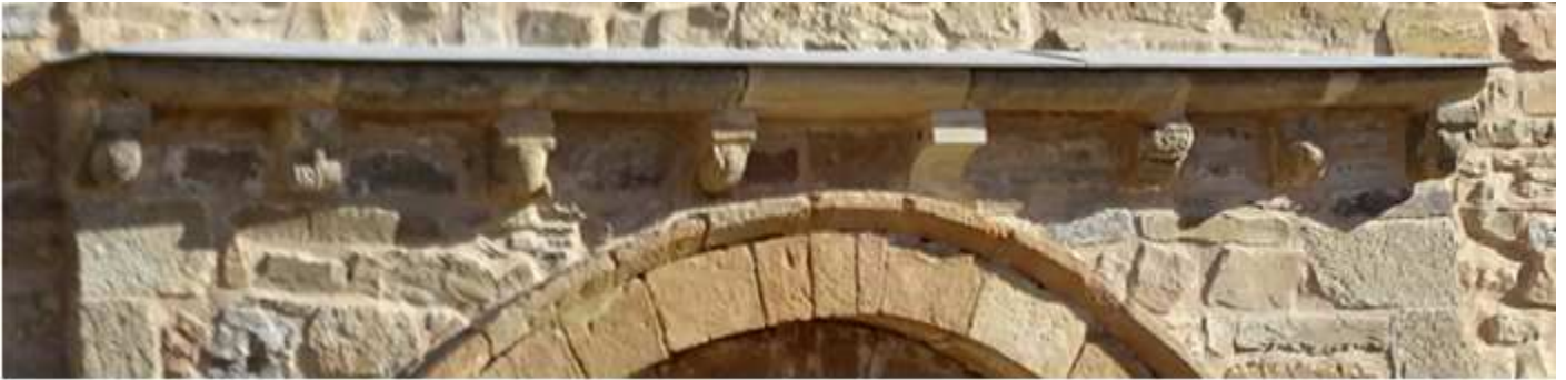
❶ Parte superior de esta portada adelantada que posee un tejaronz con ocho canecillos que son distintos. Foto: Orlando Yagüe de Miguel. Con la reforma exterior efectuada.
