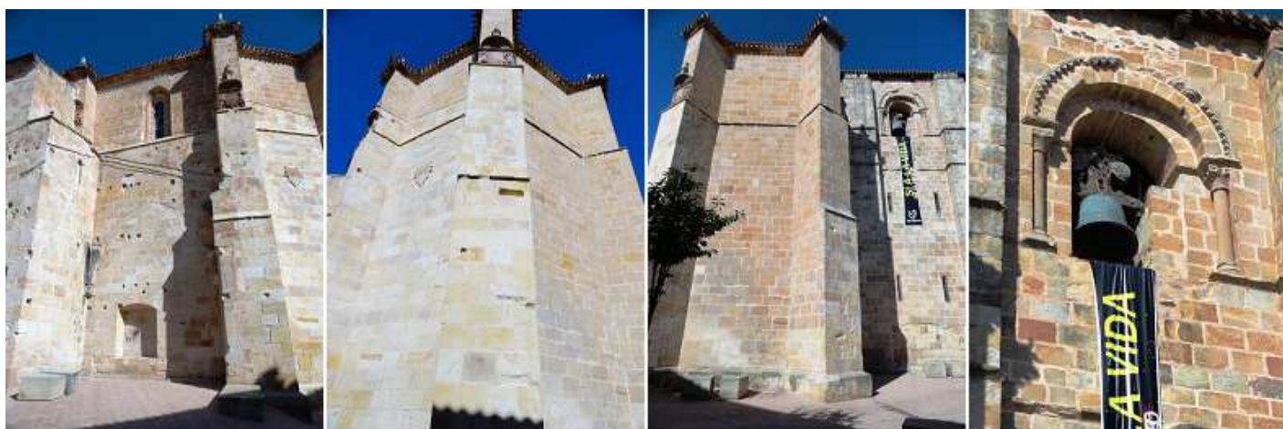
1 Lateral tras el absidiolo románico. Y el espacio de la antigua capilla de los Calderones donde aun se aprecian las ménsulas y arranques de su bóveda de crucería 2 Cabecera con grandes contrafuertes. 3 Parte de su cabecera y la torre adosada. 4 Ventana del campanario con guardapolvo de puntas de diamante y dos arquivoltas lisas. Lateral del campanario restaurado en época posterior.
