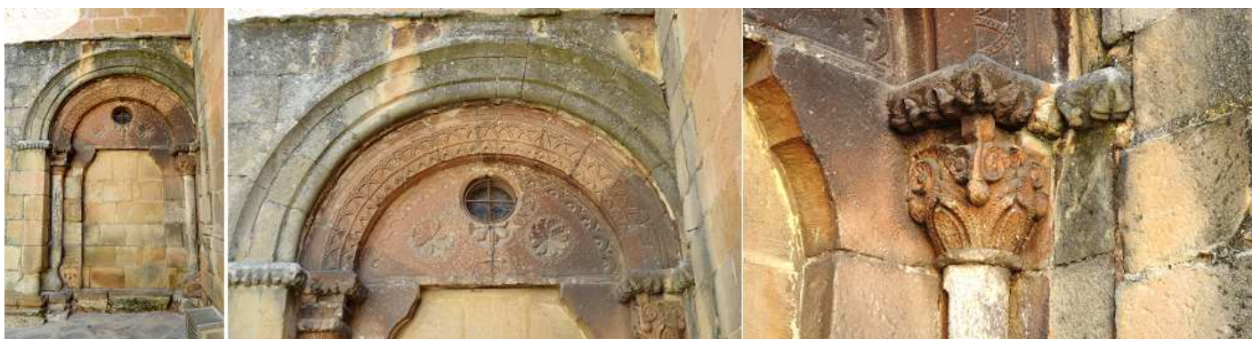
1 Portada en el lateral sur. 2 Con dos arquivoltas y un tímpano decorado con tres rosetas con una perforación posterior de un óculo que lo destroza. 3 Capitel e imposta del lado derecho.
