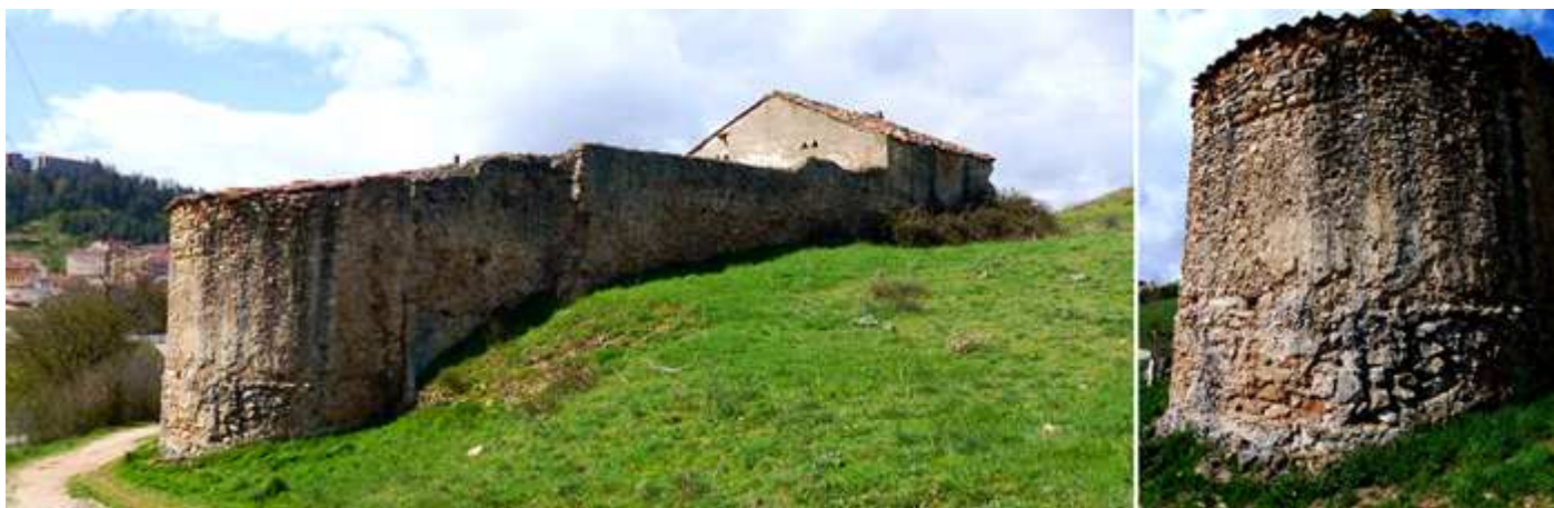
🕒 Fachada de la parte norte, donde en su presbiterio parece tener una saetera. 🕒 Su cabecera sobre un alto zócalo y construida con cantería irregular y argamasa y no posee apertura alguna. Fotos: Ayuntamiento. (elige.soria.es)
