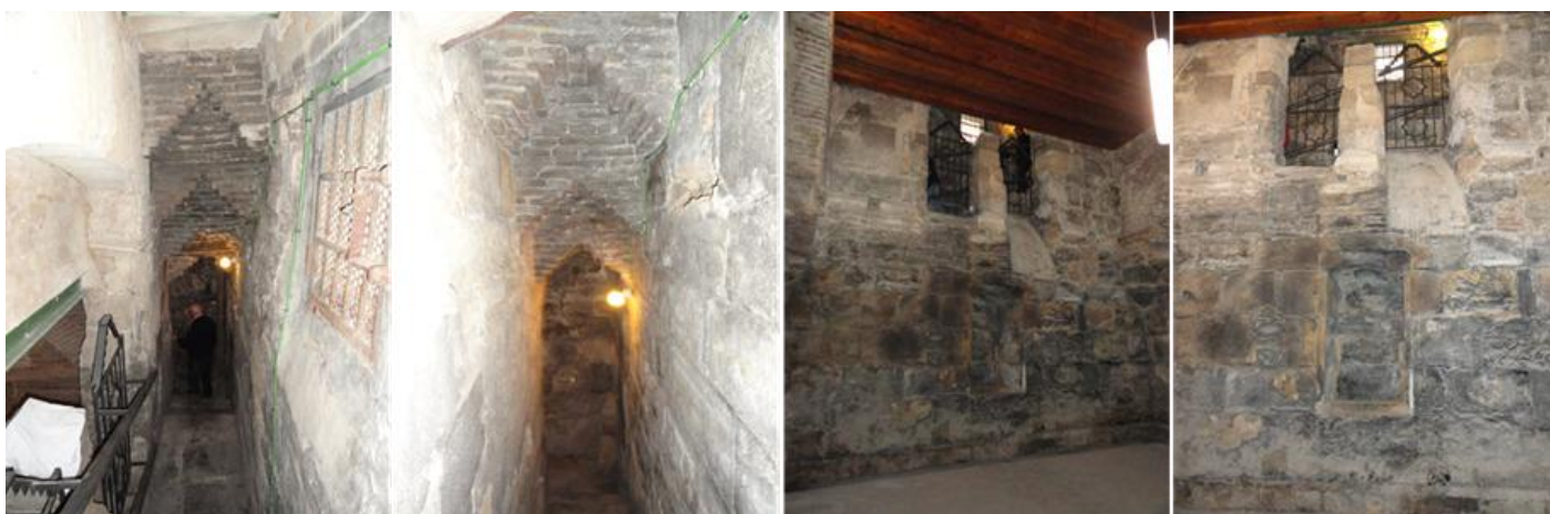
❶ Descendemos a la cripta por un estrecho pasillo y escaleras realizada intramural. ❷ Cubierta mediante bovedillas enjarjadas de ladrillo. ❸ Lo primero que llama la atención son las dos ventanas exteriores que posee en el muro norte y que se comunican a
