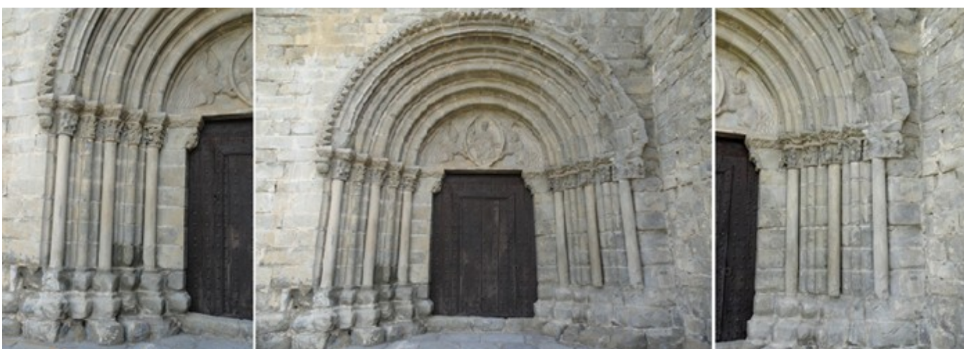
❶ Los capiteles de este lado izquierdo de izquierda a derecha: la Trinidad, el combate de San Miguel con el diablo y tres escenas vinculadas con el pecado original. ❷ Su portada cubierta con un guardapolvo de puntas de diamante y sus arquivoltas descansan en las columnas acodilladas. ❸ En el lado derecho con el sacrificio de Abraham y se prolongan con episodios de la vida de Cristo (Anunciación, Crucifixión), hasta culminar con la Resurrección.
