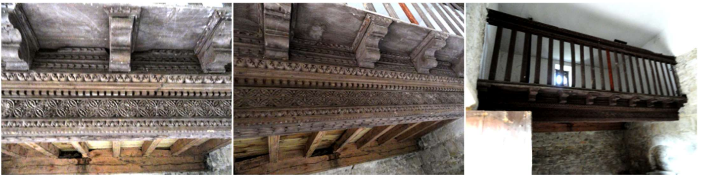
❶ Viga central del coro. ❷ Completamente labrada su cara exterior. ❸ Coro elevado de madera
