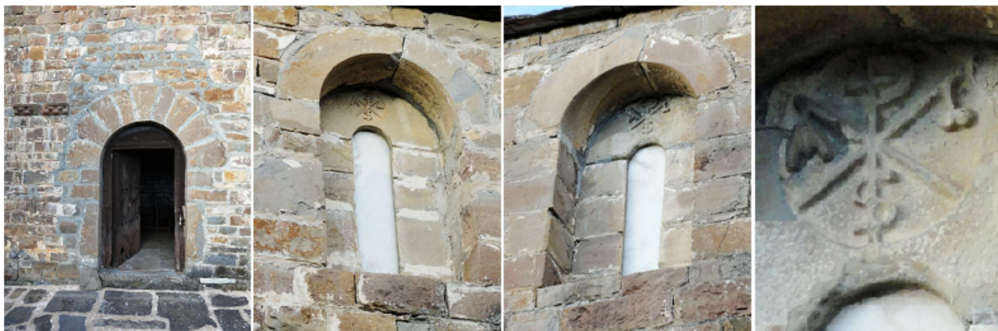
❶ Puerta con restos de decoración de taqueado jaqués a su izquierda. ❷ Ventana izquierda de este muro con crismón. ❸ Y la de su derecha también posee otro. ❹ Crismón de la ventana derecha sobre una pieza monolítica.
