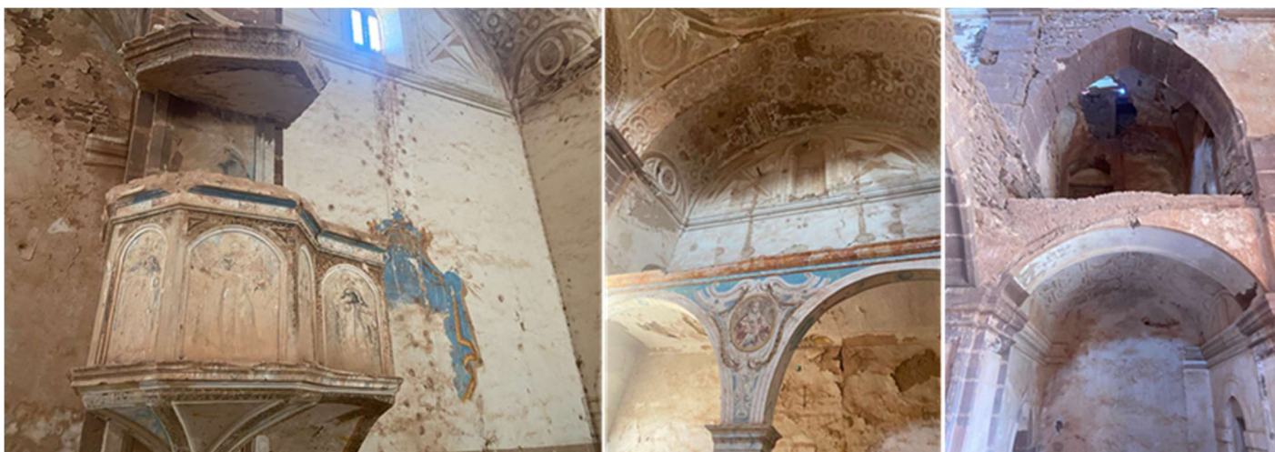
❶ Lateral del Evangelio con su púlpito con tornavoz. ❷ Conserva algunas muestras pictóricas sobre sus muros lo mismo que la decoración a base de yeserías barroco-mudéjares. ❸ Parte del coro que conserva su cubierta. ❹ ¿?.
