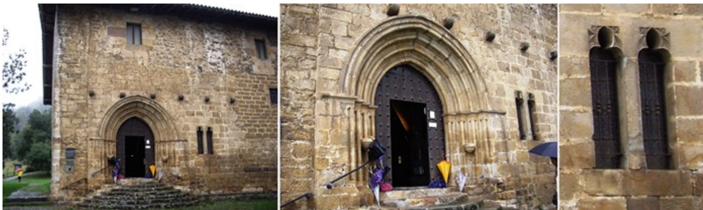
❶ Su puerta sobre un estrado de siete escalones. ❷ Su puerta de arco apuntado de cuatro arquivoltas más un guarda lluvias. Ante la portada conserva unas ménsulas donde debió sustentarse la cubierta de un pórtico ante su puerta. ❸ Ventanas con arcos trilobulados en este lateral.
